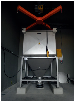
Abb. 2 Wechselcontainer für die Bevorratung der Pulveraktivkohle
